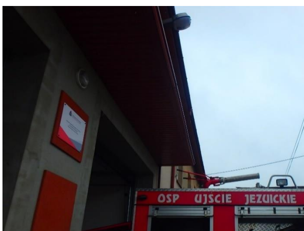
Fot.11. Armatka wodna.
